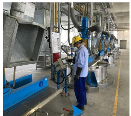
技術人員正在進行設備維護檢修。
